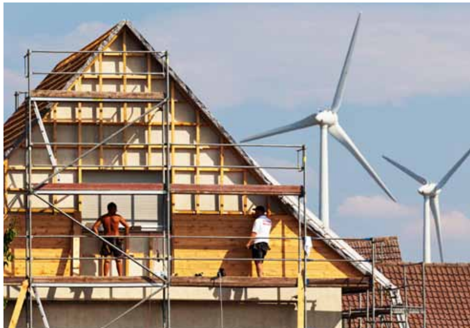
Le Conseil fédéral prévoit notamment d'augmenter les moyens financiers alloués à l'assainissement énergétique des bâtiments.
