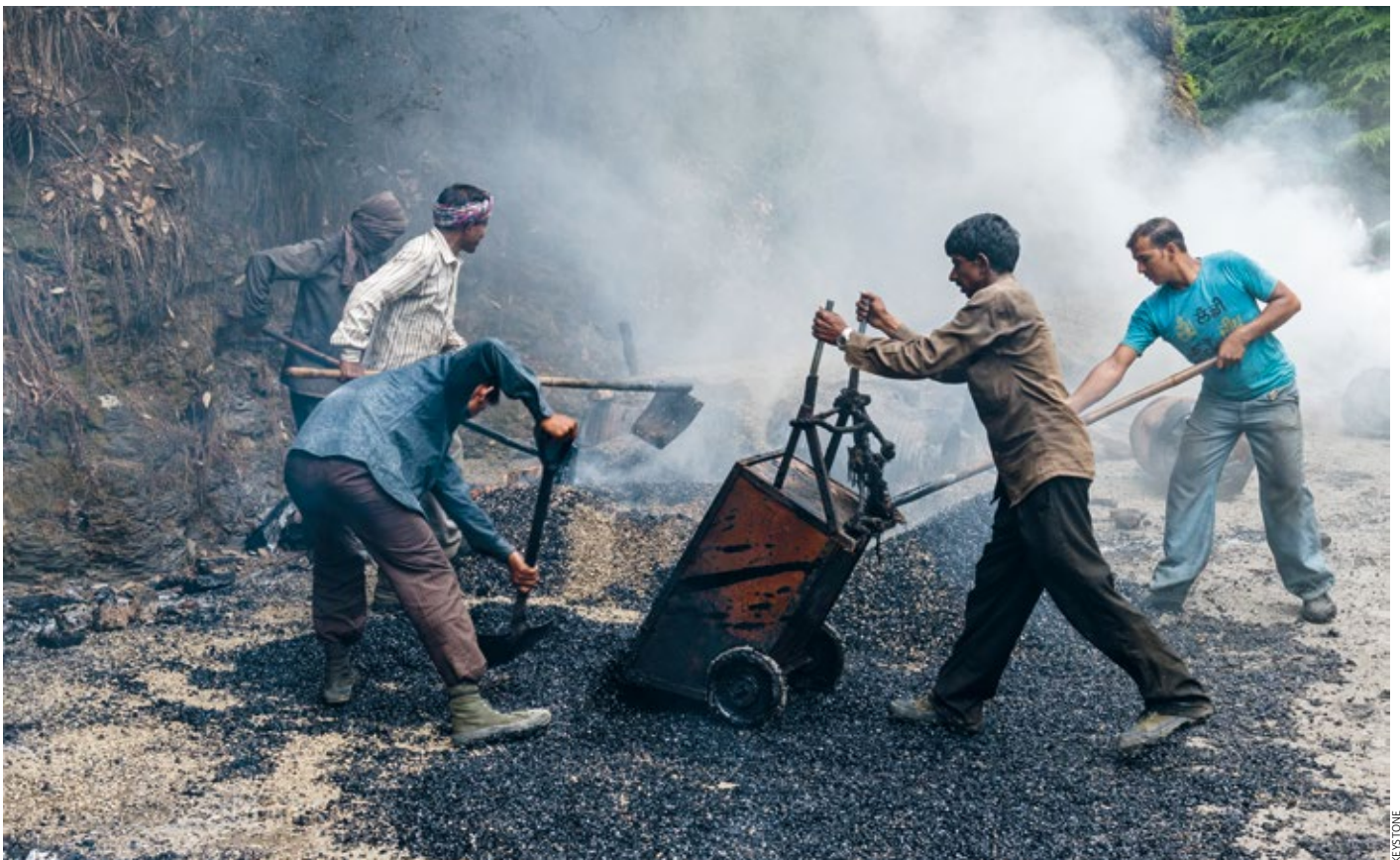
Les sommes nécessaires à la construction de routes en Asie sont colossales. Chantier en Inde.
