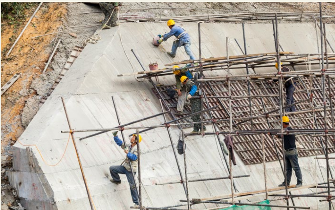
Arbeiter beim Bau eines Staudamms in Laos. Kritiker bemängeln, dass solche Grossprojekte kaum Arbeitsplätze für die Bevölkerung schaffen.
