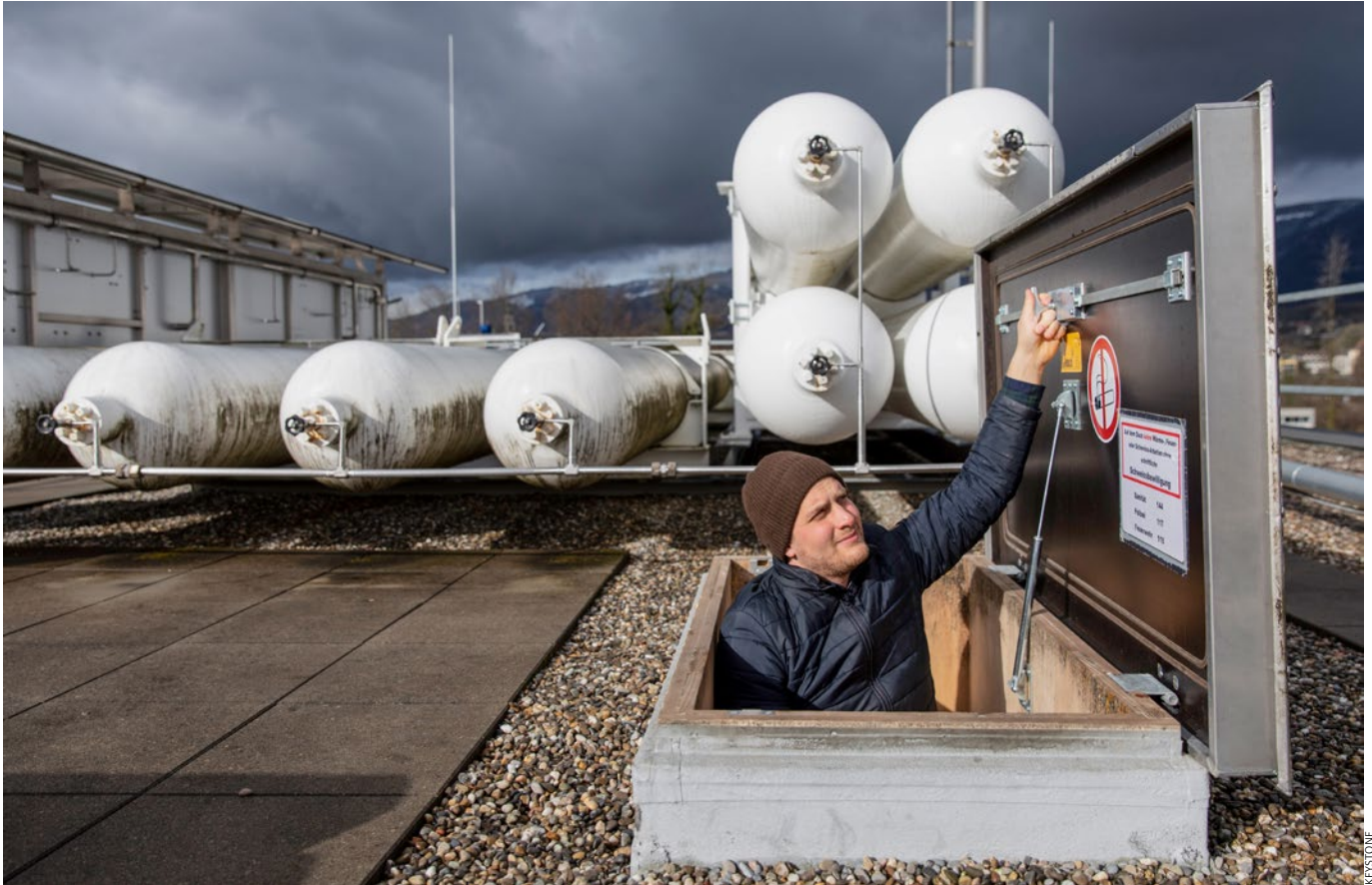
Eine gute Regulierung ermöglicht Innovation. Wasserstofftanks in Zuchwil SO.
