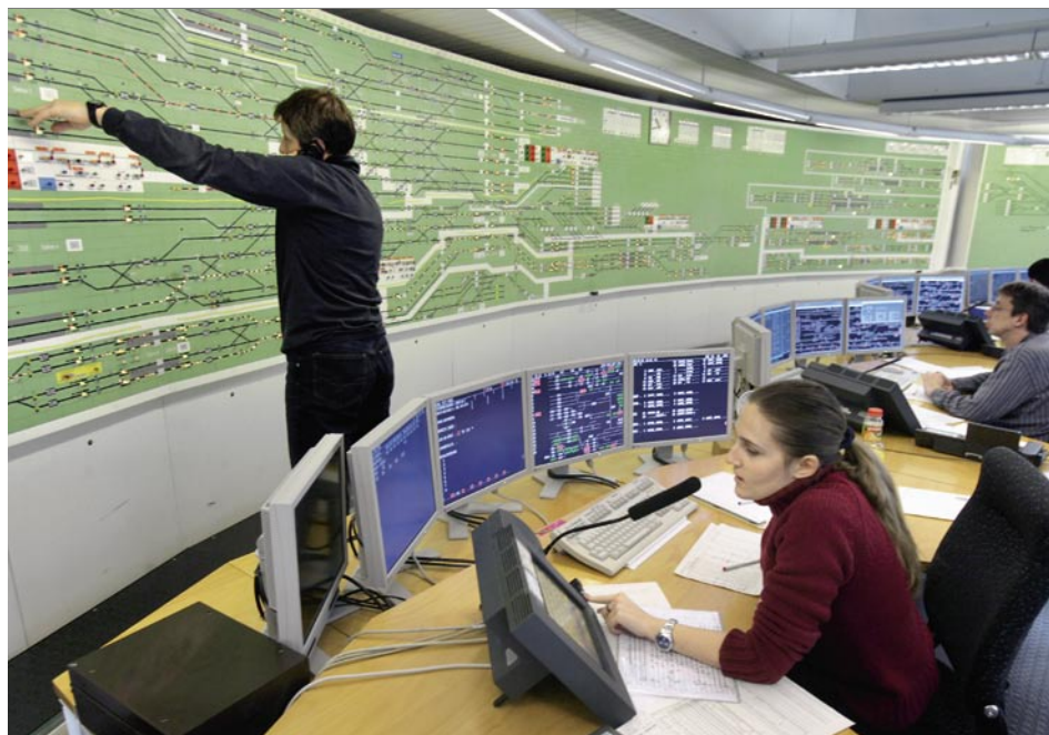
Les systèmes de contrôle, pour la gestion des transports et du trafic par exemple, sont devenus, étant donné leur importance, synonymes d'infrastructures critiques. Les mesures pour les protéger sont d'autant plus nécessaires. En illustration: appareil d'enclenchement des CFF.
