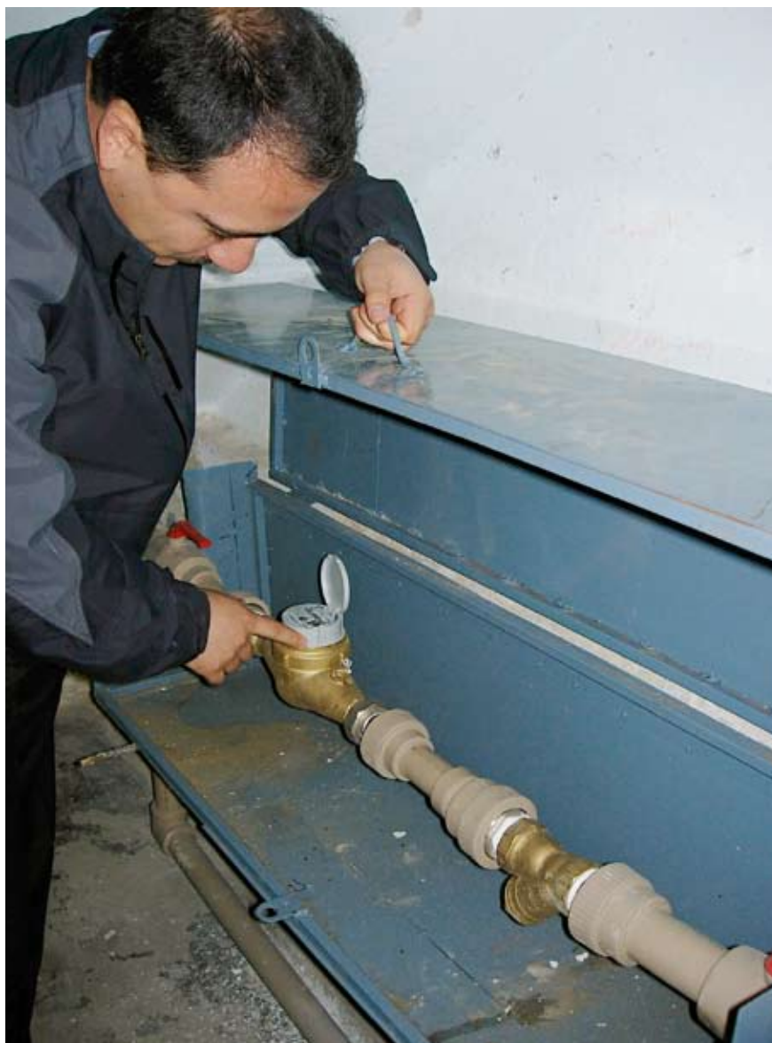
In Tadschikistan führen das Seco und der EBRD ein gemeinsames Projekt zur Wasserversorgung durch. Dank der Installation neuer Wasserzähler (im Bild) konnten die Wasserverluste deutlich reduziert werden.
